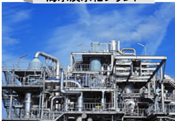
海水淡水化プラント
