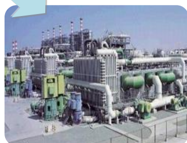
海水淡水化プラント
