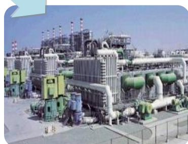
海水淡水化プラント
